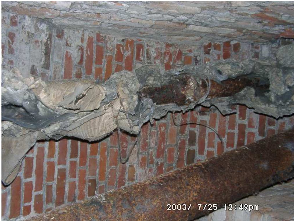
Fot. 11 Rury instalacyjne pod mostem
