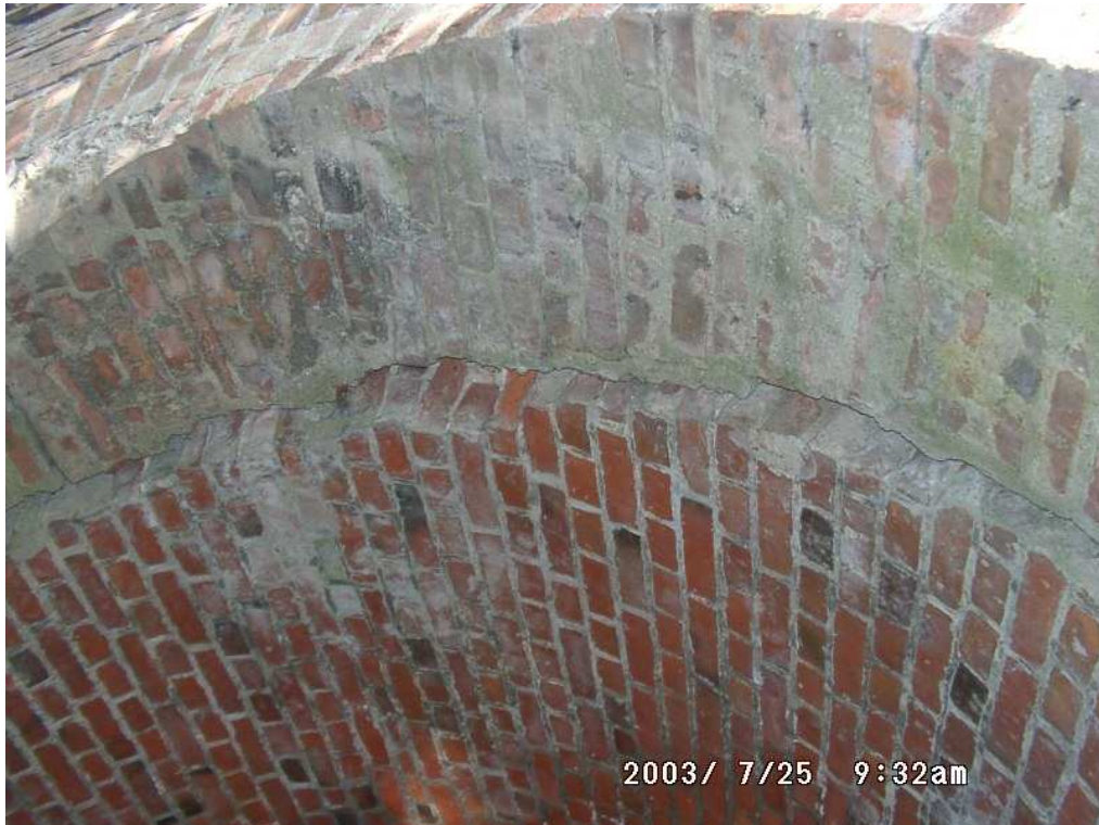
Fot. 9 Pęknięcie sklepienia od strony południowej
