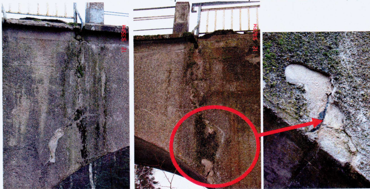
Fot. 9, 10, 11. Ślady zarysowań w miejscach połączenia przęśła z przyczółkami mostu.
