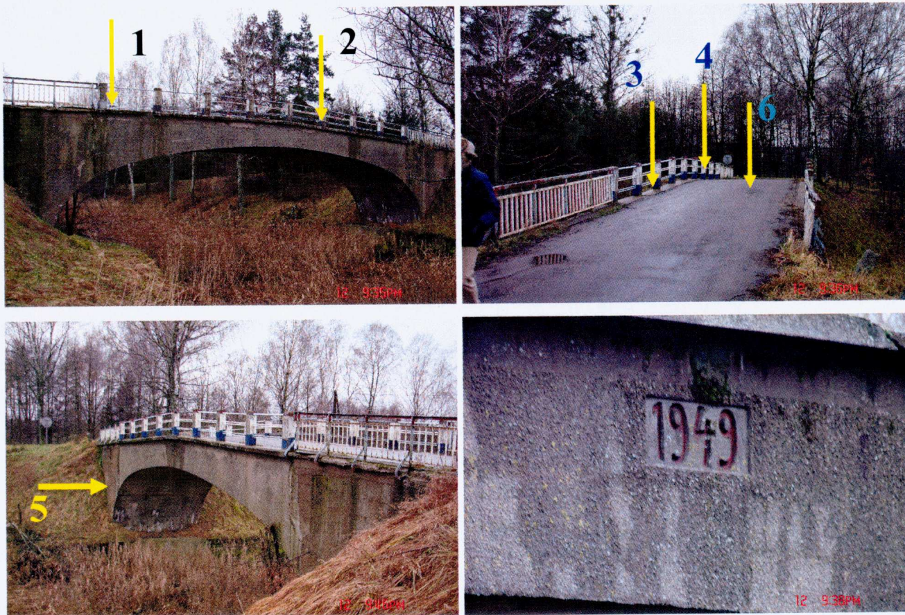
Fot. 1, 2, 3, 4. Widok ogólny mostu łukowego na Kanale Mazurskim w miejscowości Bajory Małe z zaznaczonymi (1, 2, 3, 4, 5) miejscami pobrania próbek – odwiertów.
