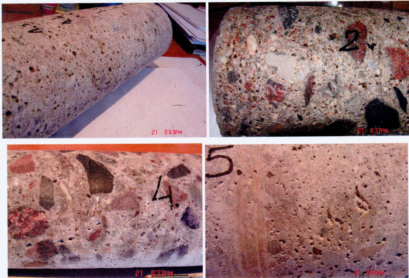
Fot. 24, 25, 26, 27. Struktura betonu w pobranych próbkach. Beton wykazuje liczne pęcherzyki powietrzne, które mogą świadczyć o zastosowaniu środków napowietrzających przy produkcji mieszanki. Stos okrucowy szczelny. Brak widocznych śladów uszkodzeń.
