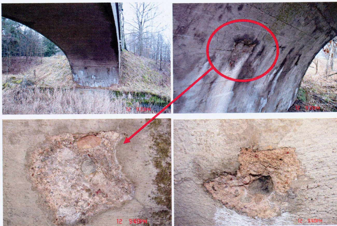
Fot. 5, 6, 7, 8. Ślady korozji alkalicznej i siarczanowej betonu w przyczółku mostu.
