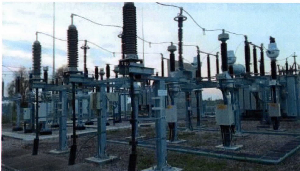
Pole rozdzielcze linii GPZ Pleśno II – GPZ Korsze
