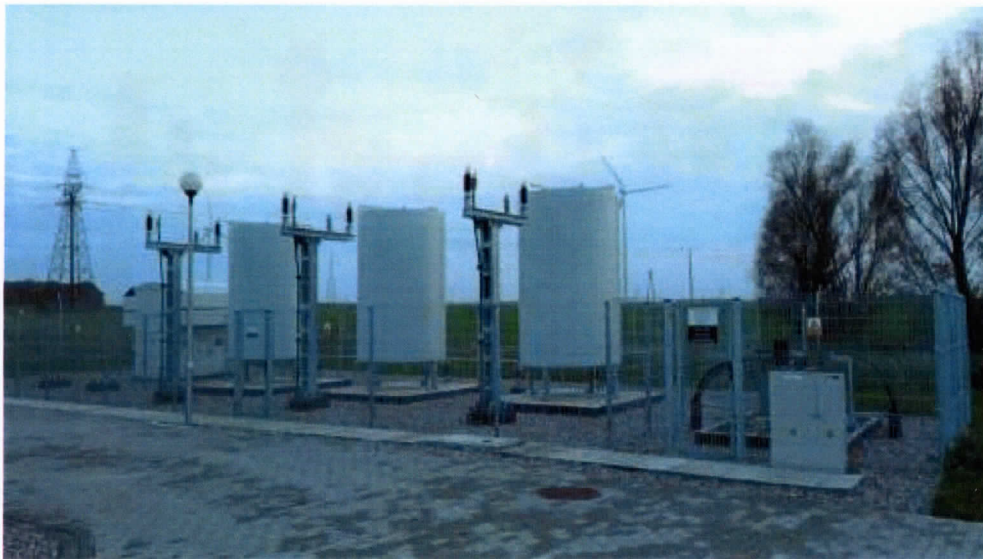
Bateria kondensatorów WN
