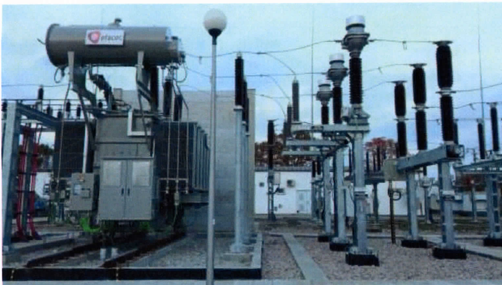
Pole rozdzielcze transformatora TR2
