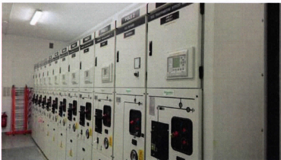
Wnętrzowa rozdzielnia 30 kV
