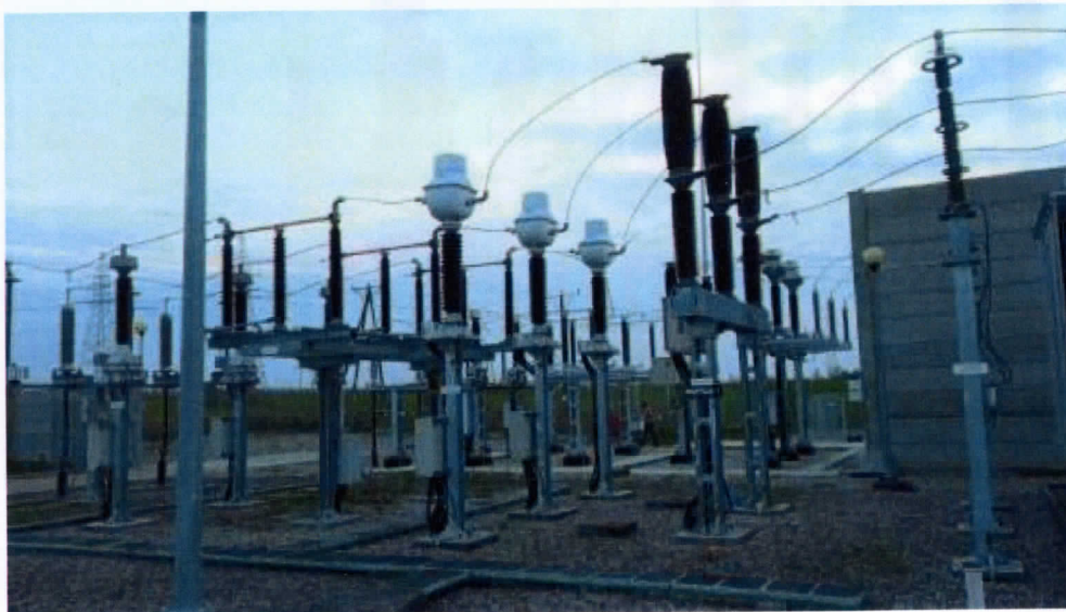
Pole rozdzielcze transformatora TR1
