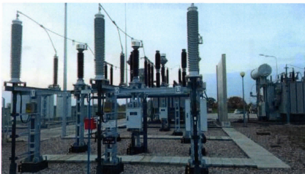
Pole rozdzielcze linii GPZ Korsze – FW Gudziki Pleśno II
